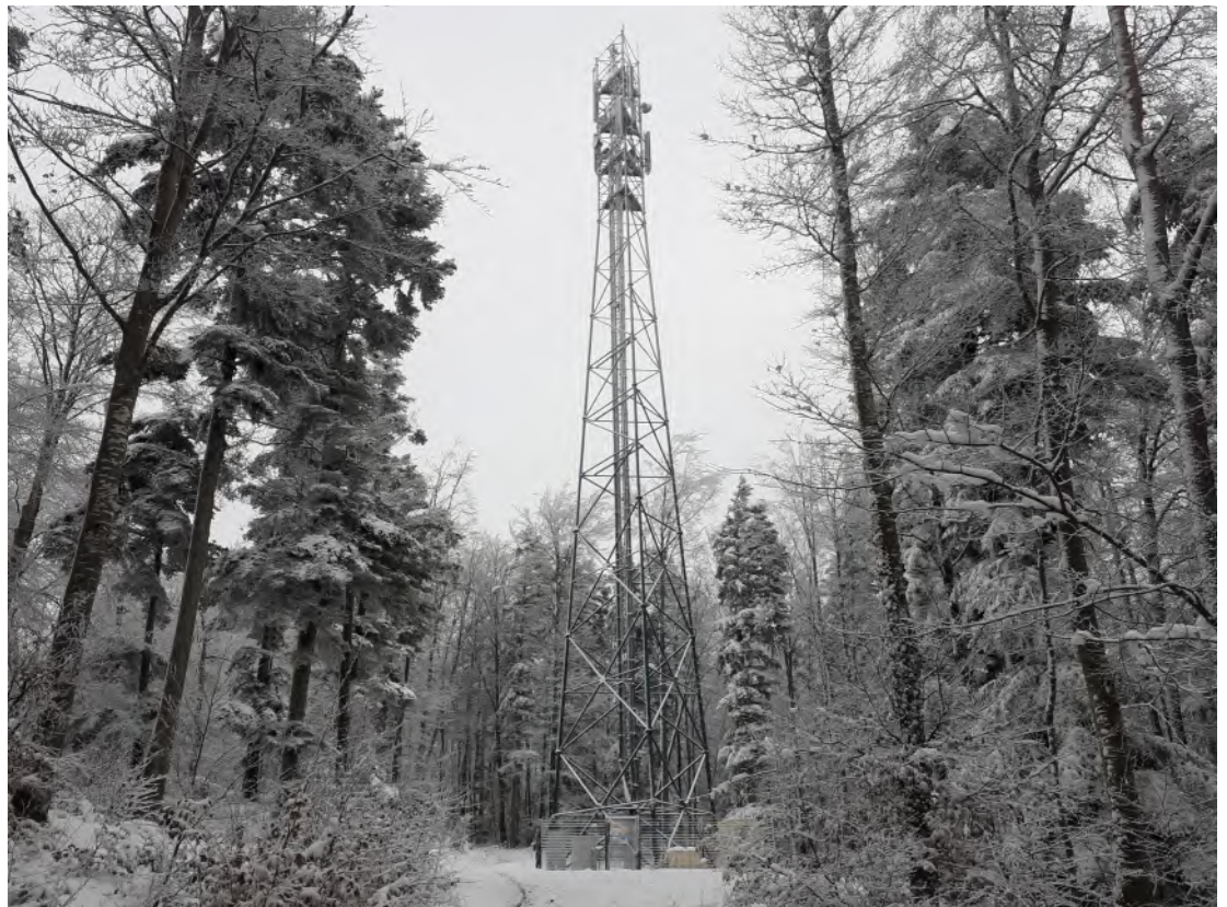
Antenne relais du Glaserberg
